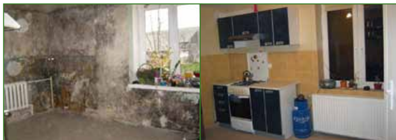
Mieszkanie pacjenta WHD z aspergilozą – przed remontem i po remoncie.
